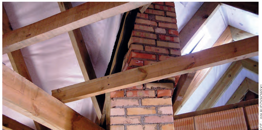
Fot. 1. Przekrój komina, wykonany niezgodnie z projektem
